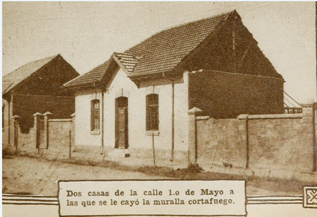
FIGURA 5. Casas de la Población Obrero Ferroviaria siniestradas durante temblor. Fuente: Revista Sucesos, 1927.
